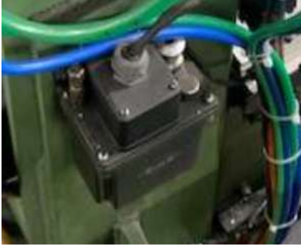
Bild 6.1 Die alte Schmierung funktionierte nicht mehr. Die Schmierleitungen waren ebenfalls gebrochen. Das Schmiersystem hatte auch keine Ueberwachunsfunktionen.
