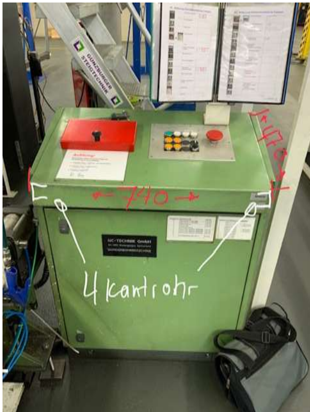
Bild 4.1 Alte Steuerung vor dem Umbau
