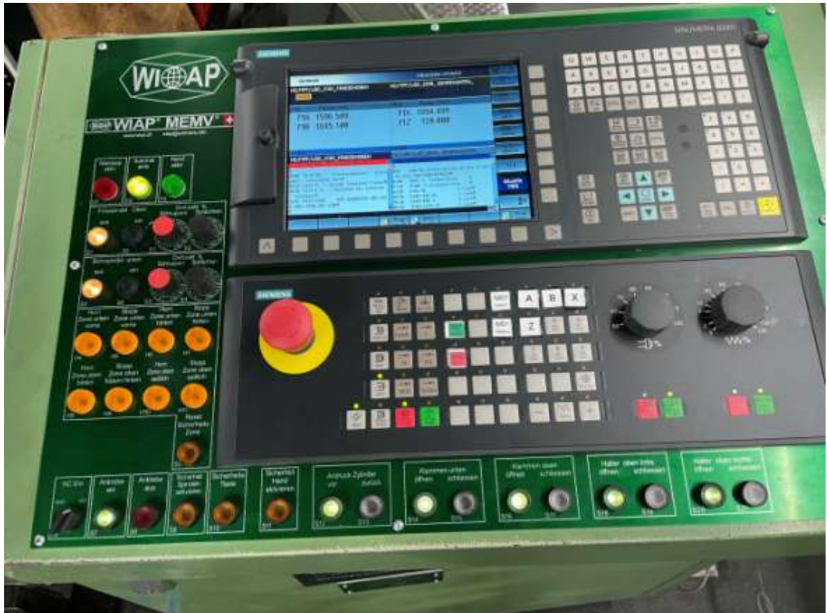
Bild. 7. 1_1 Neue CNC-Steuerung, bei der beide Kanäle gleichzeitig angezeigt werden kann sein
