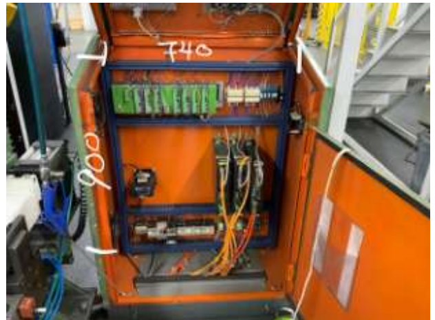
Bild 4.2 Schaltschrank intern vor dem Umbau, vorher.
