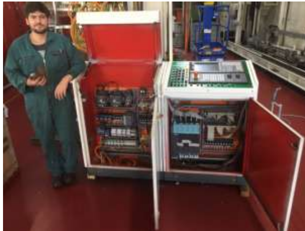
Bild 7. In der linken Schrankhälfte sind 3 Frequenzumformer angebracht.
