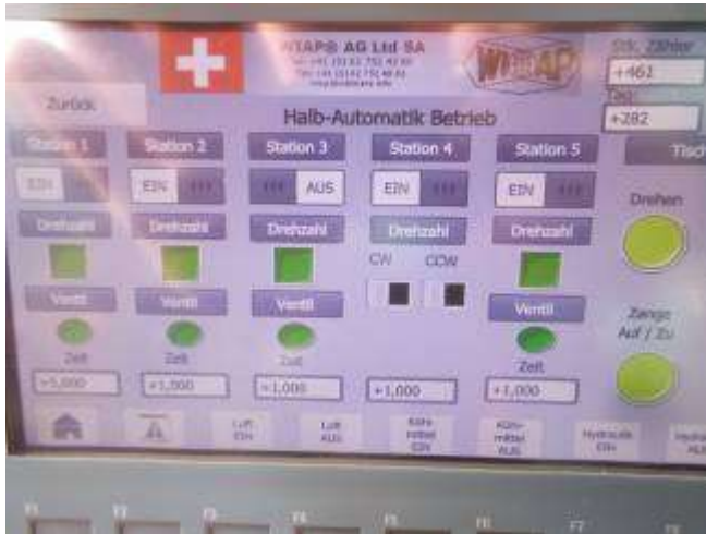
Bild 5.3 Bitte entschuldigen Sie die schlechte Bildqualität. Hier ist immer noch die Original Folie von Siemens drauf die wir erst nach der Inbetriebnahme weggezogen. Es gibt immer eine Hand und eine Halbautomat und Automaten Titelseite, wo je nach dem, was man will, gestartet werden kann. Der Ablauf geht alles Vollautomatische diese Maschine taktet z.B in 4 Sekunden ein Teil.
