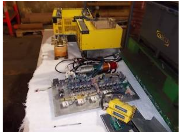
Figure 10: Ausgebautes control material of the Fanuc 18i. WU_232_100
