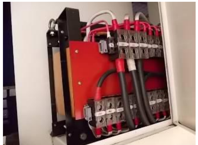
P23) Ein grosser Transformator, der die 230/400 Volt auf 115/220 Volt reduziert.
