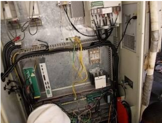
P25) Bald ist alles schön eingebaut und es hat noch ein wenig Reserveplatz.
