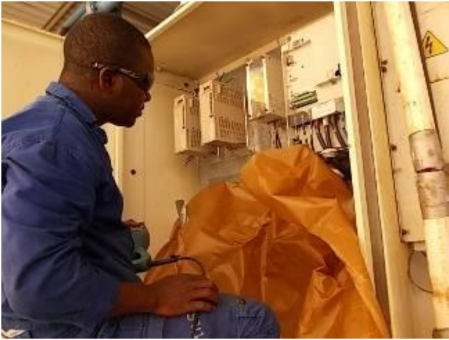
P24) Wir mussten den Jungen erklären, wenn sie beim Bohren nicht abdecken, kann es beim Einschalten einen Knall geben, weil Späne in der Elektrik und Elektronik unzulässig sind. Darum muss immer alles abgedeckt werden, wenn gebohrt wird.
