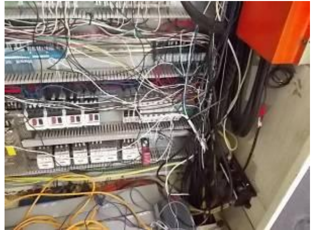
P9) Gemischte Kabelvernetzung. Auffallend ist, der Maschinenhersteller hat für die 220 Volt den 0 Leiter, wie auch die Speisung, mit diversen Farben gemacht. Kabel, die zu kurz waren, wurden mit Kabeln von verschiedenen Farben verlängert. Einige im Kabelkanal waren zusammen gelötet!
