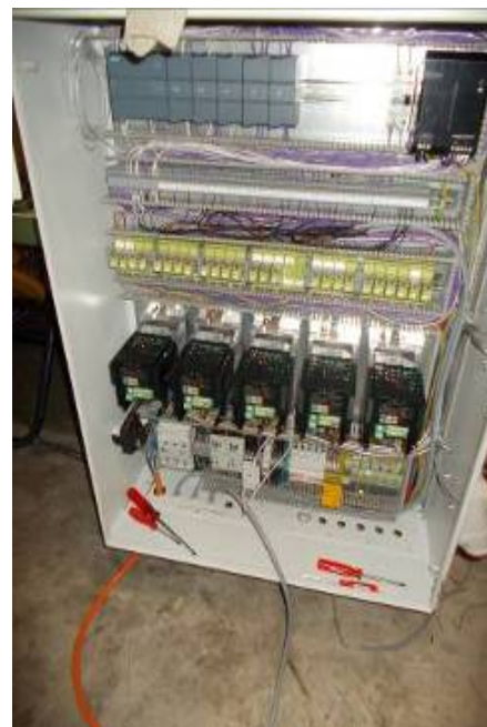
Für alle Motoren der Einheiten haben wir anstelle mit Schützen gleich 5 Stück Frequenzumformer mit jeweils 0.75 KW eingebaut. Diese können stufenlos reguliert werden. Von 0 bis 70 Hertz, nach Wunsch auch bis 100 Hz möglich. D.h. doppelte Drehzahl. Oben ist die S71200 angeordnet. WU5140c
