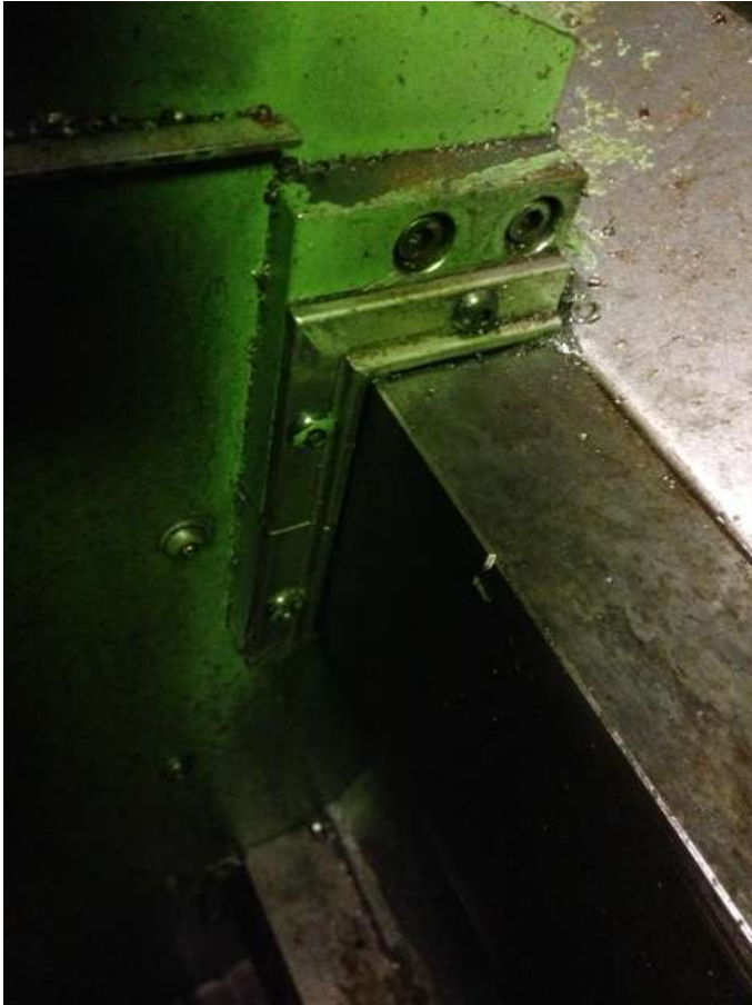
Bild 4: Die Abstreifen der Schweren CNC Drehmaschine GF NDM 25 sollten ersetzt werden.
