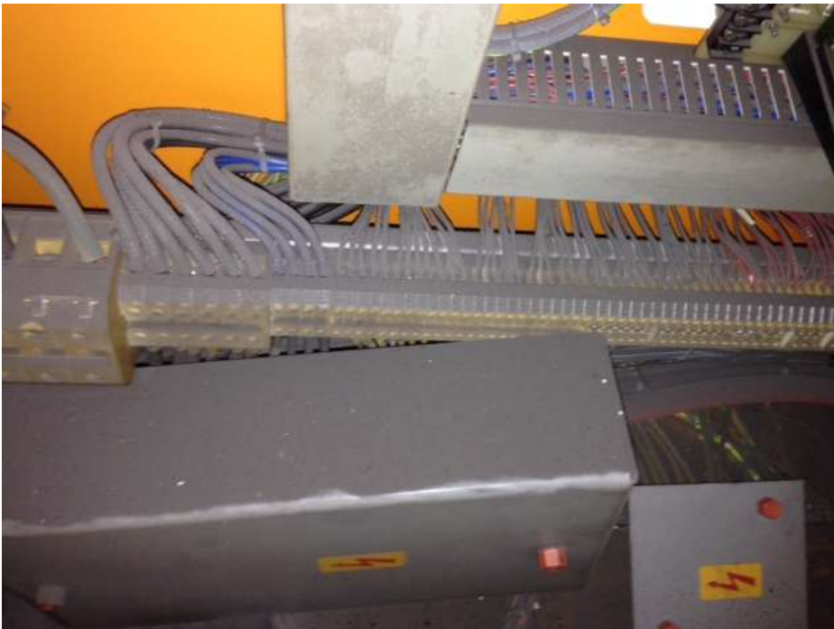
Bild 13 : Der Elektroschrank sieht bedenklich aus. Alle Klemmen sind mit Dickem Gusstaub belegt. Wenn die Maschine über die Feiertage steht und der Staub feucht wird, kann beim Einschalten einiges zerstört werden. Das Problem: Die Maschine ist schon so alt, dass die Hersteller der Elektronik sagen können: „ Das haben wir nicht mehr“.
