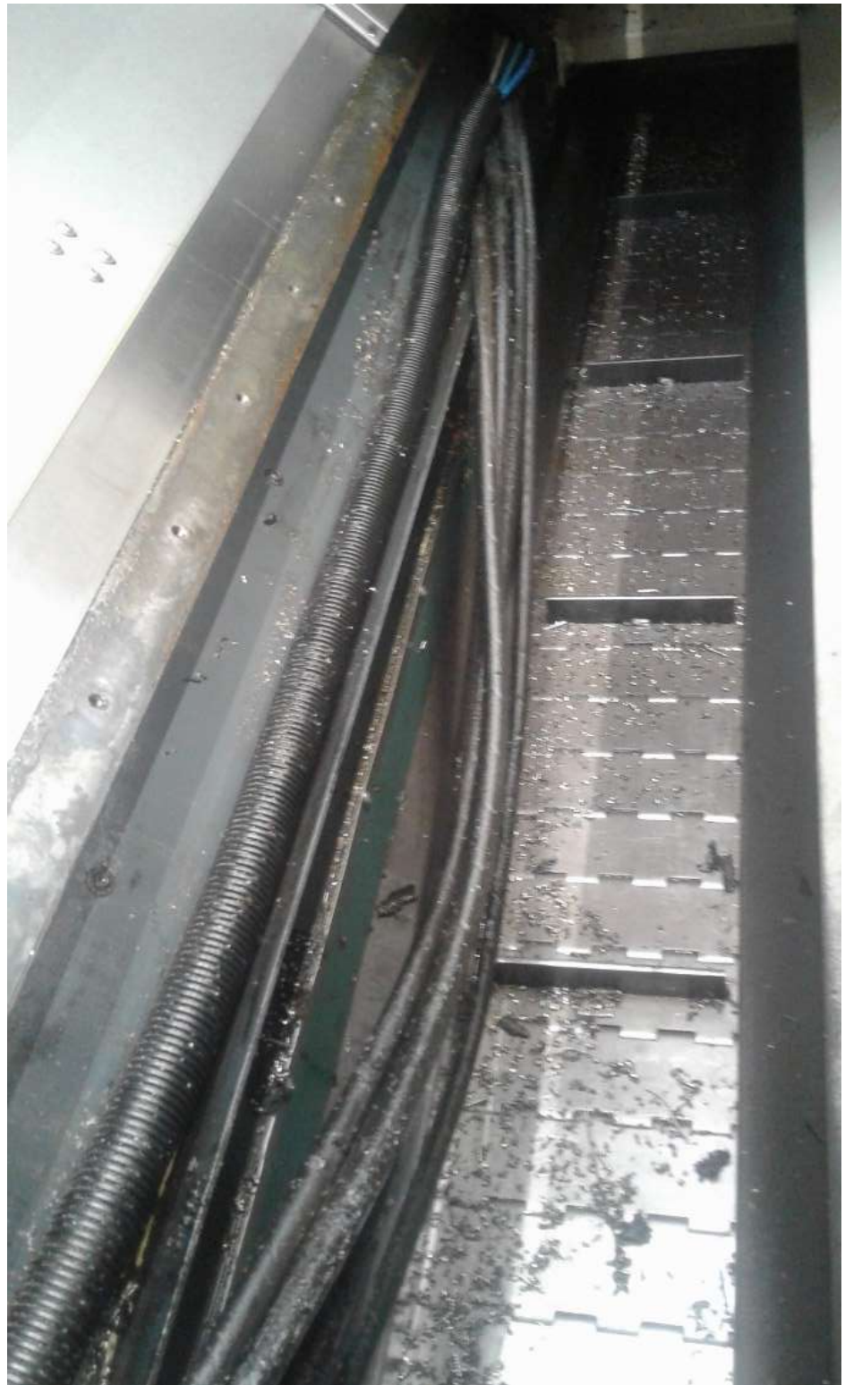
Bild 9: Die Schläuche sind unter einer Abdeckung, eigentlich gut versteckt- Diese sollten nicht von Spänen beschädigt werden können.
