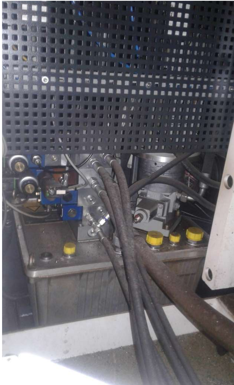
Bild 10. Die Schläuche gehen hinten vom Hydraulik Aggregat im Maschinenraum durch alles durch.
