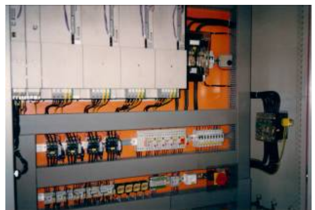
Bild 9: Neu aufgebauter Elektroschrank, alles Siemens Material.
