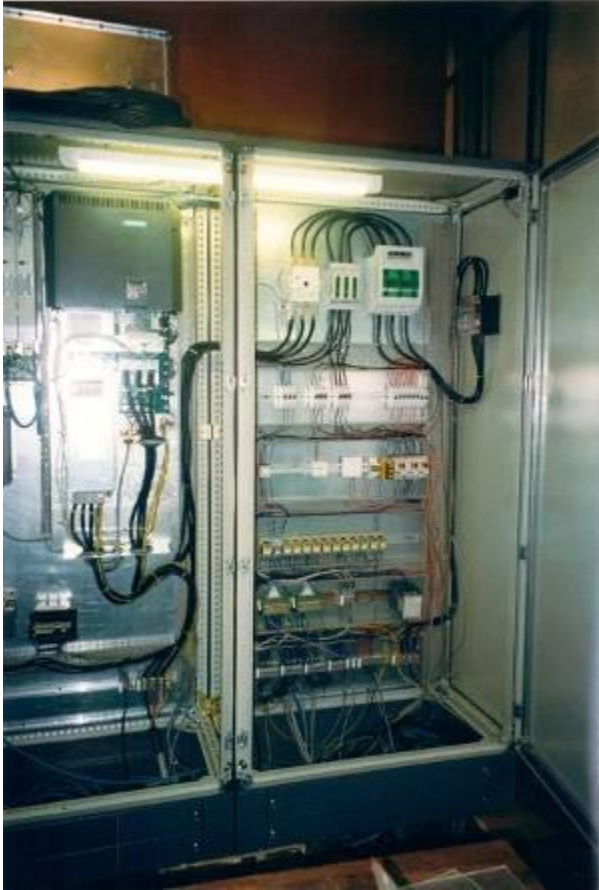
Bild 8: Der gesamte elektrische Teil wurde komplett erneuert. Alle, nicht wie die alten mit 220 Volt versorgten Schalter, gegen 24 Volt DC ausgetauscht. Neues Notaus System, neuer Spindeltrieb und Vorschubsystem.
