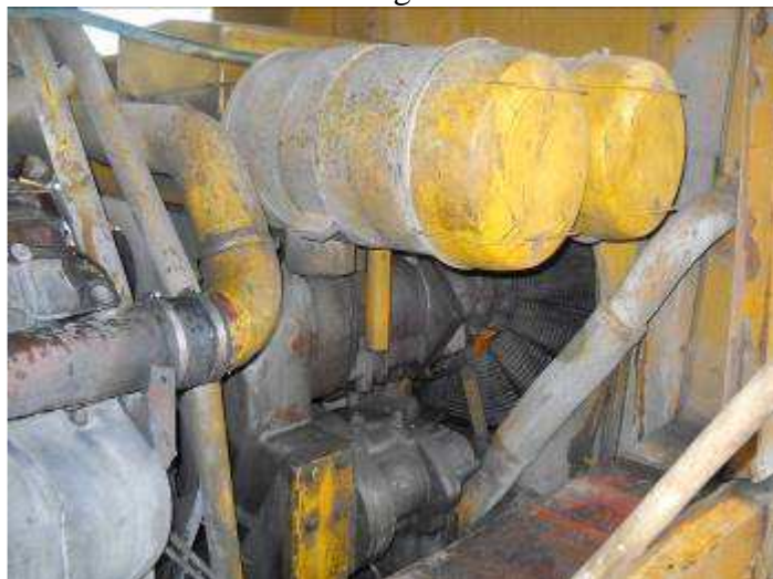
Photo: Hier sind die Luftfilter der Anlage.
