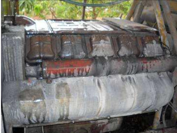
Photo: Der Kompressor hat ein Deutz Motor der Luftgekühlt ist. Das ist nicht ideal für Vietnam weil die Luft viel zu heiss ist in Vietnam. Man kühlt nun den Motor zusätzlich mit Wasser.
