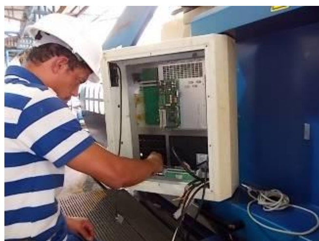
P28) Carlo prepara o novo controle CNC antes. Estamos felizes porque sabem-los dentro e fora.
