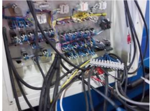
P4) Innenansicht des alten Panel. Auffallend ist, dass hier ein 50-poliges Kabel die CNC vorne zur CNC hinten verbindet. Wir ersetzen das mit einem Profibus Kabel, 2-polig.
