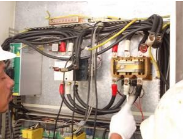
P7) Dicke Kabel sind hier im Einsatz. Das dickste ist 80 mm 2 .
