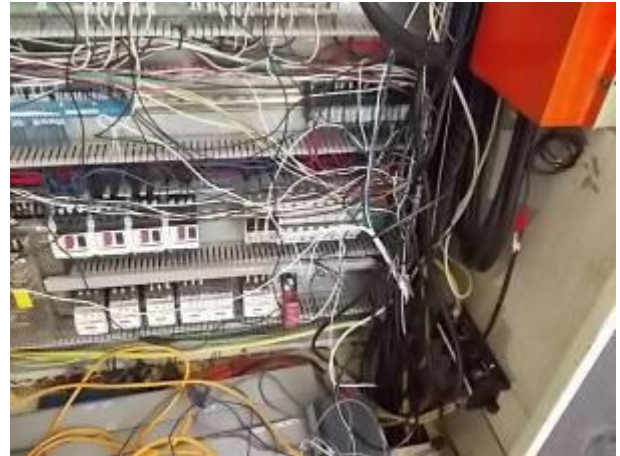
P9) Gemischte Kabelvernetzung. Auffallend ist, der Maschinenhersteller hat für die 220 Volt den 0 Leiter, wie auch die Speisung, mit diversen Farben gemacht. Kabel, die zu kurz waren, wurden mit Kabeln von verschiedenen Farben verlängert. Einige im Kabelkanal waren zusammen gelötet!
