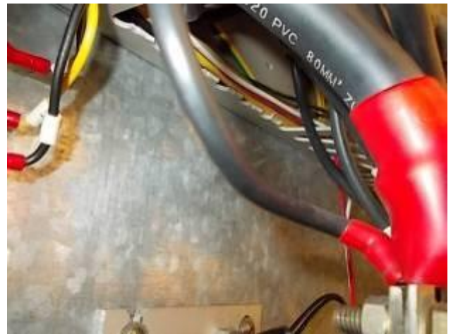
P22) Vorne 80 mm 2 , hinten 10 mm 2 . Unsicher schliessen wir den 10 mm 2 direkt an einer Sicherung an.
