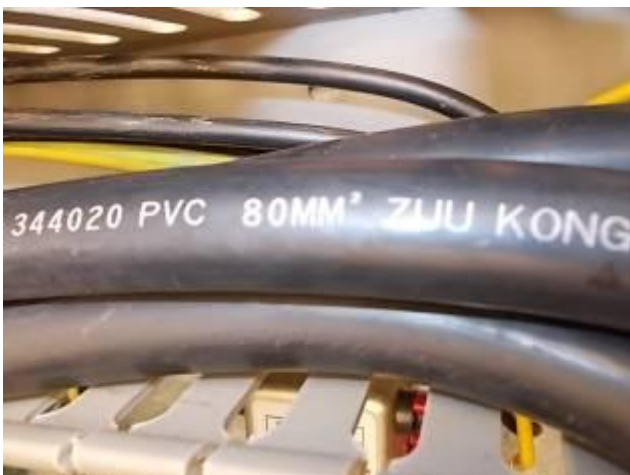
P20) Da drin sind Kabel mit 80 mm 2 . Da die Maschine im Herkunftsland mit 115/220 Volt betrieben wird, sind diese dicken Kabel installiert worden.
