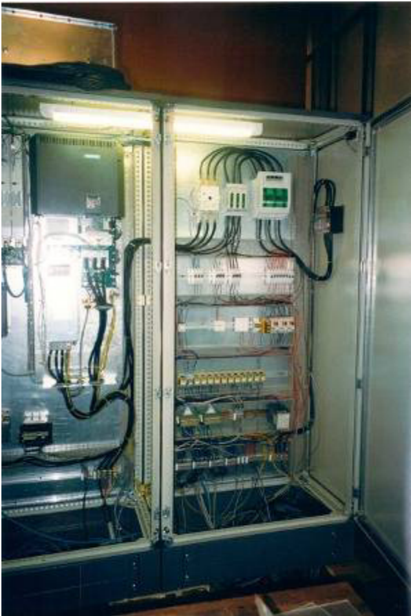
Der gesamte elektrische Teil wurde komplett erneuert. Alle, nicht wie die alten mit 220 Volt versorgten Schalter gegen 24 Volt DC ausgetauscht. Neues Notaus System, neuer Spindeltrieb und Vorschubsystem. WU4625
